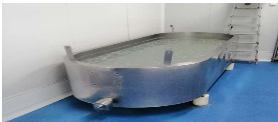
10 DEPOSITO ACERO INOX 1.200 L
